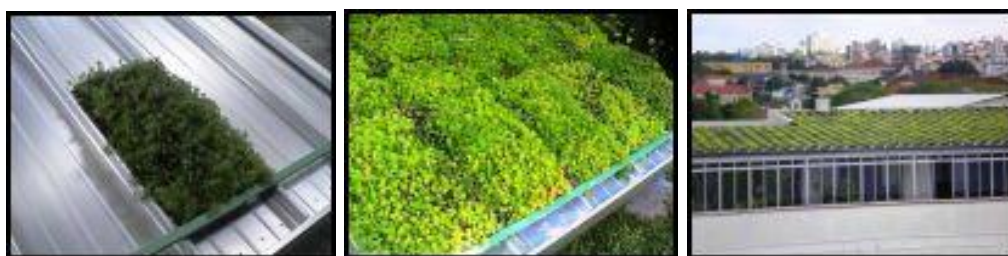
Figura 73 – Módulos vegetados em cobertura industrial - Porto Alegre Fonte: ECOTELHADO (2008)
