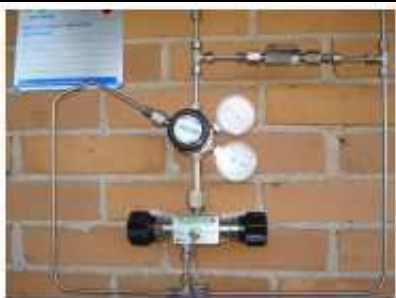
Figura 4.5 - Reguladores de pressão da rede de gás (mistura H_2/H_2S ).
