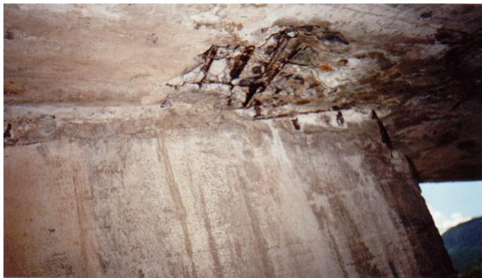
FIGURA 10 - FOTO FALHAS DE CONCRETAGEM
