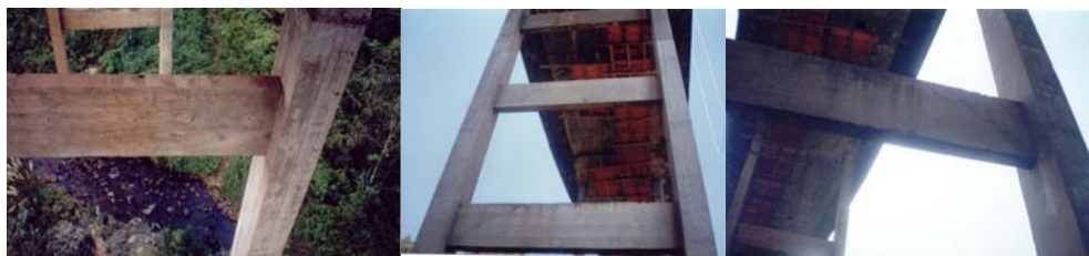
FIGURA 13 - FOTO FISSURAS NAS TRAVESSAS
