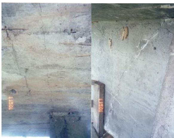
FIGURA 21 - FOTO RACHADURAS JUNTO AO PILAR P-50 EM ELEMENTOS ESTRUTURAIS E LONGARINA
