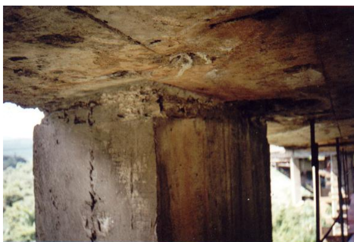
FIGURA 8 - FOTO PATOLOGIA LIGAÇÃO PILAR CAIXÃO
