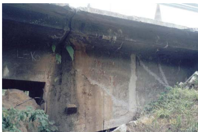
FIGURA 9 - FOTO RACHADURAS NOS ENCONTROS
