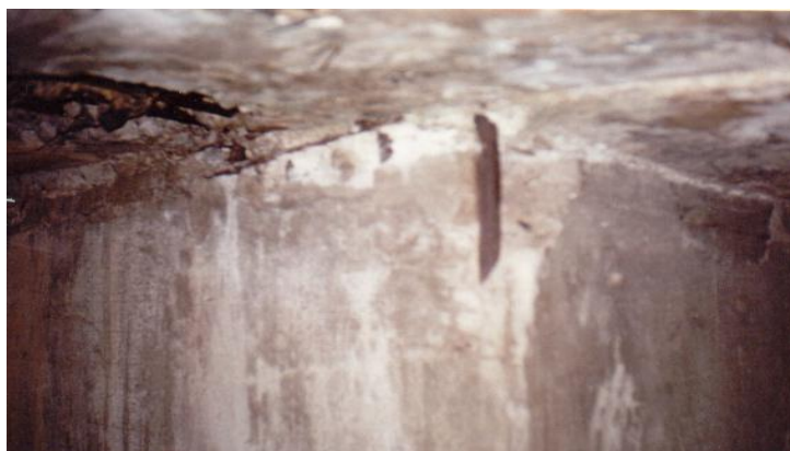
FIGURA 11 - FOTO ARMADURAS EXPOSTAS NOS PILARES
