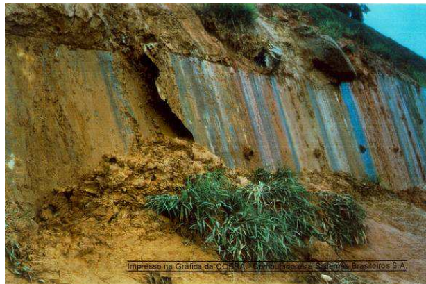
Figura 3.2 - Muro de concreto ciclópico logo após o seu rompimento em 1997 FONTE: PETROBRAS (1997)
