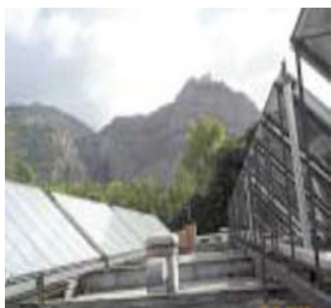
Figura 2-6. Painéis de aquecimento solar AMG instalados no teto de uma residência
