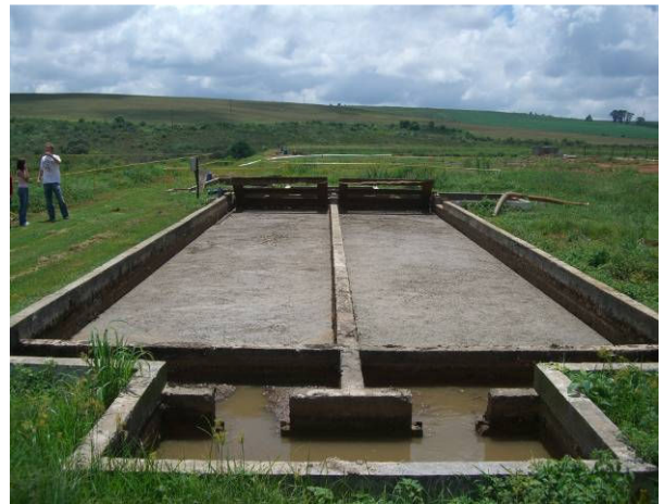
Figura 4. Caixa de gordura da unidade de produtos cárneos.
