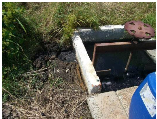
Figura 8. Detalhe do ponto de saída do efluente de uma das lagoas anaeróbias.
