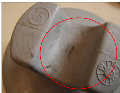
Figura 38 - Isolador de pino apresentando acúmulo de sal na região de apoio do cabo coberto, após 40 dias
