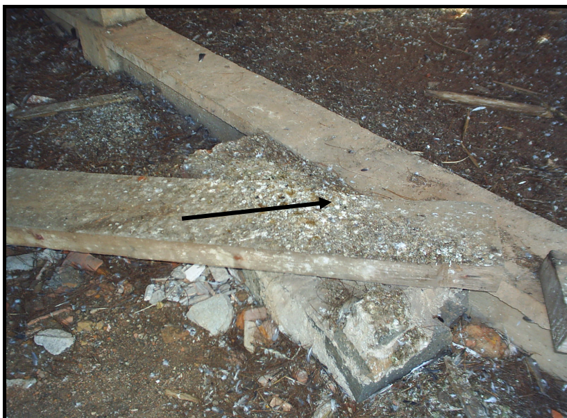
FIGURA 4 - MOSTRA VIGAS DE MADEIRA DO TELHADO DO PRÉDIO DO CEASA, A AMOSTRA DESTA LOCAL FOI POSITIVA PARA O ISOLAMENTO DA AMOSTRA 74
