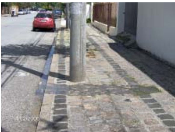
Figura 1.1 - Vazamento de efluentes domésticos, escoando diretamente para galeria pluvial, rua Atilio Bório, bairro Cristo Rei, em Curitiba.
