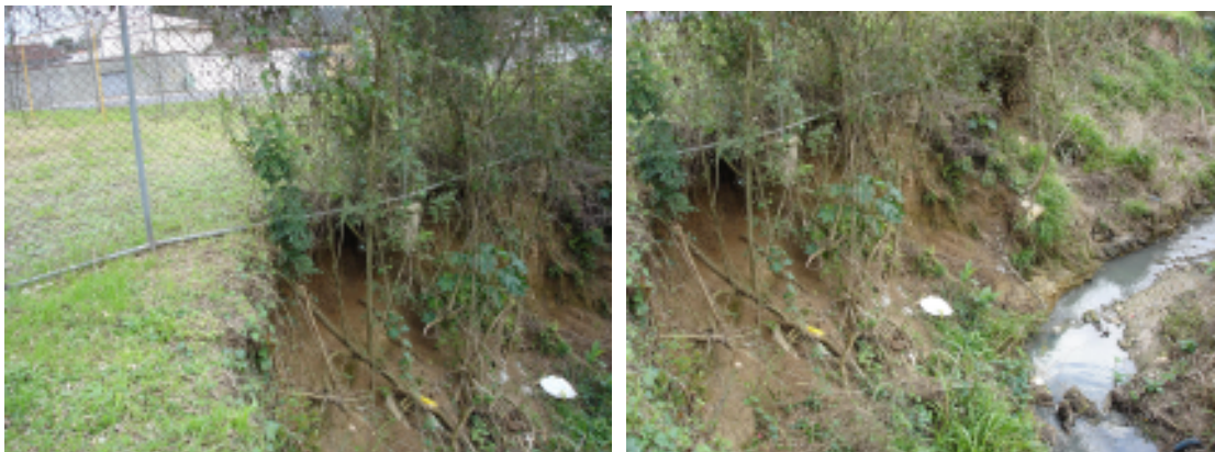
A) Erosão marginal e assoreamento do rio. À esquerda, alambrado de campo de futebol.*
