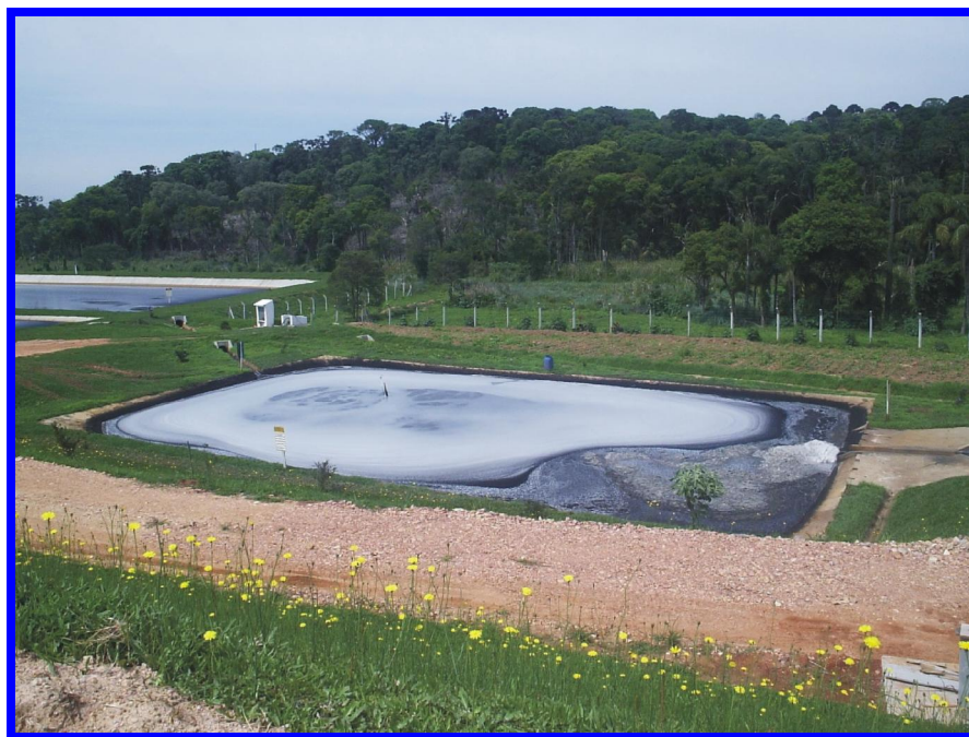
Figura 4.4.13 Lagoa de estabilização do chorume. Fonte: Local: Aterro Sanitário da Caximba. Pesquisa de campo (nov, 2006).
