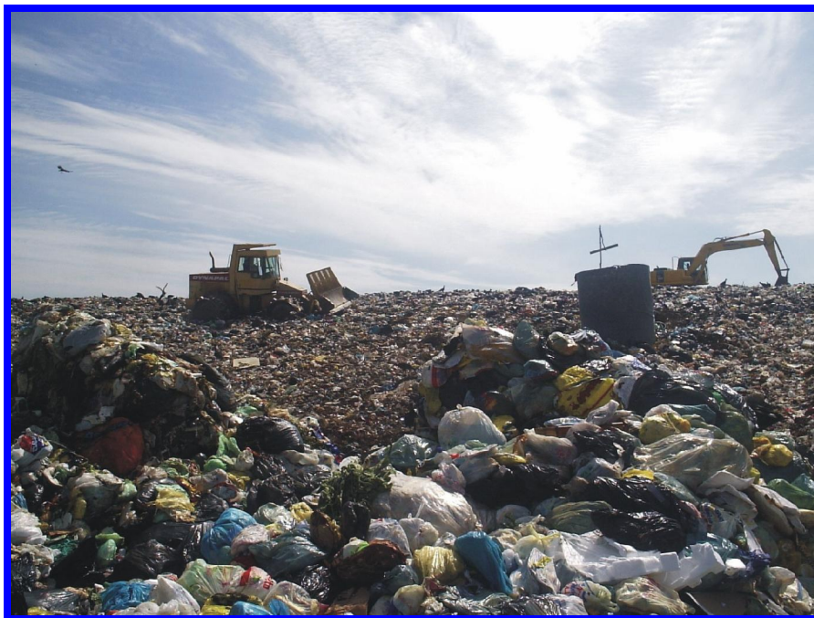
Figura 4.4.6 Momento de compactação do lixo no interior da célula. Fonte: Local: Aterro Sanitário da Caximba. Pesquisa de campo (nov, 2006).
