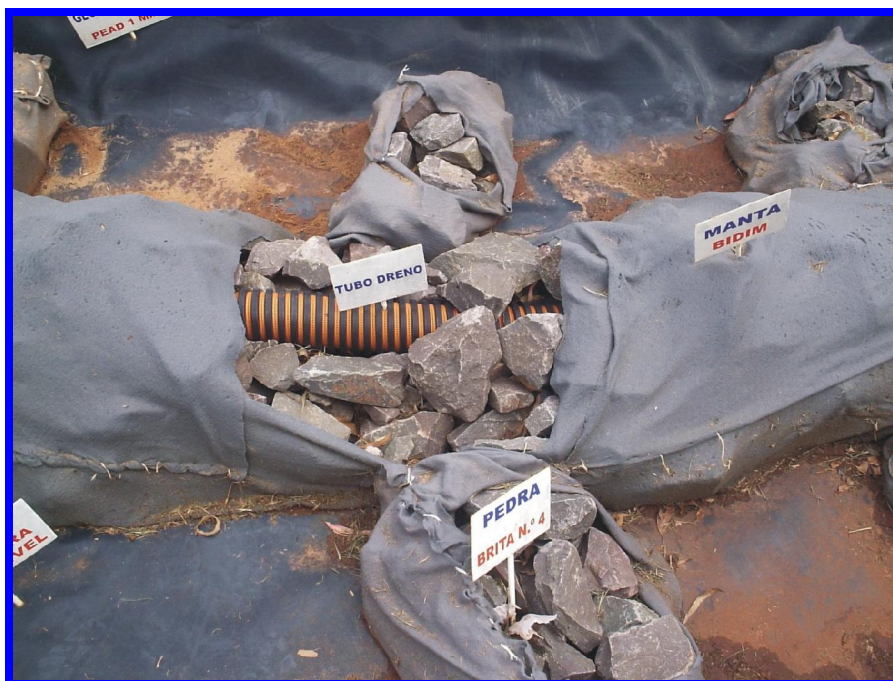
Figura 4.4.2 Modelo de sistema de drenagem no interior da célula. Fonte: Local: Aterro Sanitário de Cianorte. Pesquisa de campo (nov, 2006).
