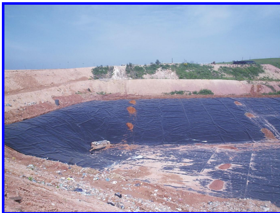
Figura 4.4.1 Sistema de impermeabilização de fundo da célula. Fonte: Local: Aterro Sanitário da Caximba. Pesquisa de campo (nov, 2006).
