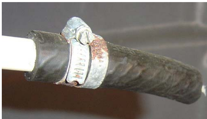
Ilustração 30– Braçadeira metálica apresentando sinais de oxidação
