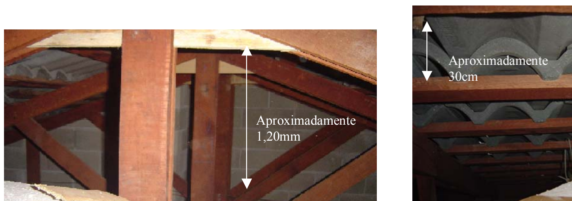
Ilustração 22 -Espaço limitado sob o telhado e dificuldades para entrada de materiais entre as ripas das telhas.
