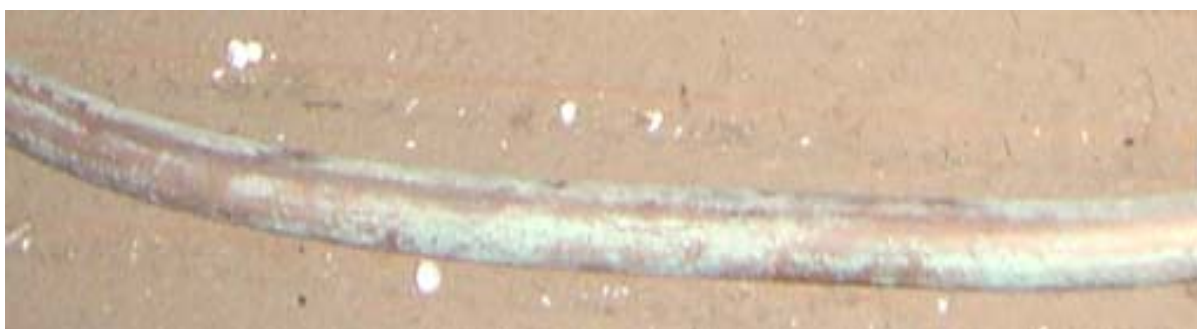
Ilustração 31 – Tubulação da serpentina apresentando camada de zinabre, que pode ser facilmente removida com um pano seco.
