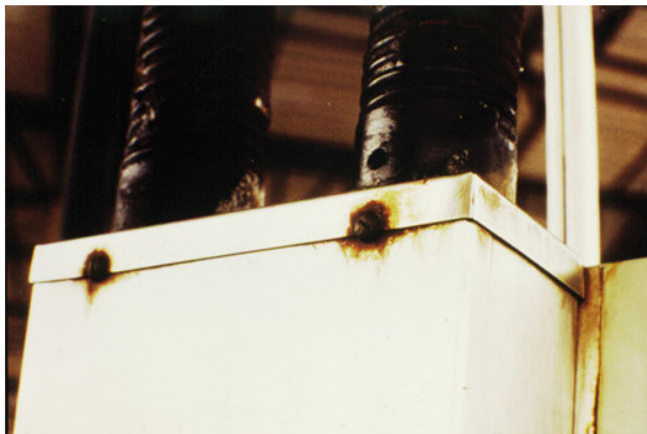
FIGURA 3 - CORROSÃO GALVÂNICA RESULTANTE DA FIXAÇÃO DE PARTES DE AÇO INOXIDÁVEL AISI 304 COM FIXADORES DE AÇO-CARBONO (ANODO). [GENTIL, 2003].
