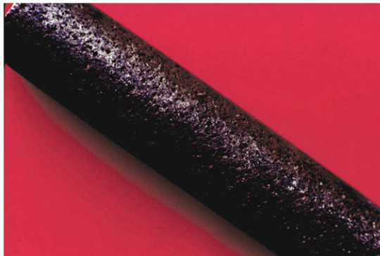
FIGURA 5 - ASPECTO DE UM TUBO DE AÇO-CARBONO QUE APRESENTA CORROSÃO POR PITE [GENTIL, 2003].
