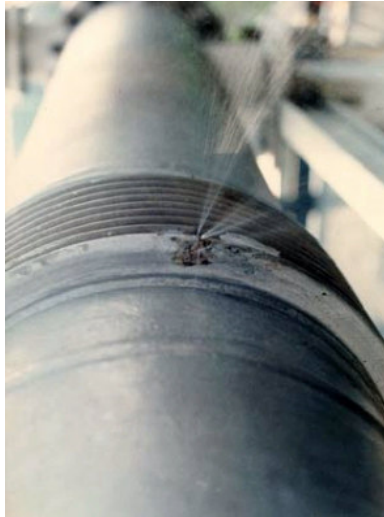
FIGURA 10 - CORROSÃO POR FADIGA EM JUNTA DE EXPANSÃO [GENTIL, 2003].
