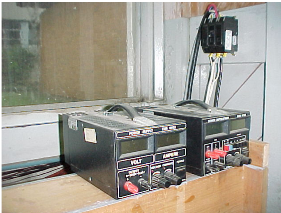
Figura 10 - Ponto de força e fontes de alimentação
