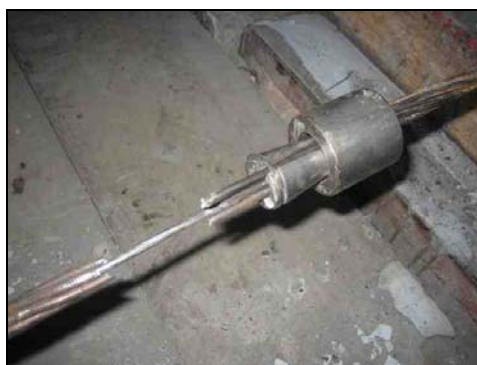
FOTO 5.1: ROMPIMENTO DA CORDOALHA C1 L3
