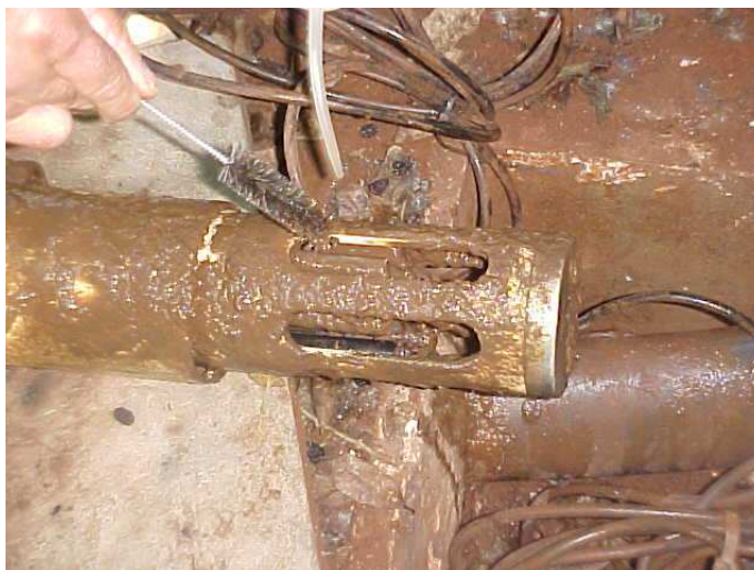
Figura 101 – Acúmulo de sedimentos na sonda de medição.
