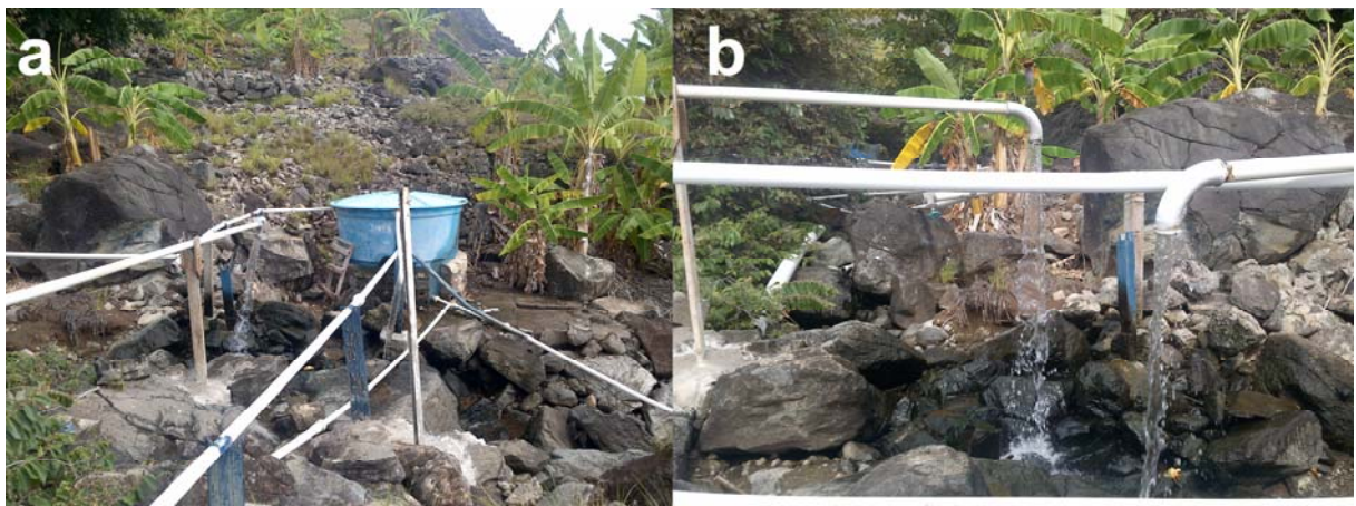
Figura 46: Rede de captação de água na Praia dos Portugueses (a) e (b) vazão da água da nascente (LECOST – UFPR 2016).
