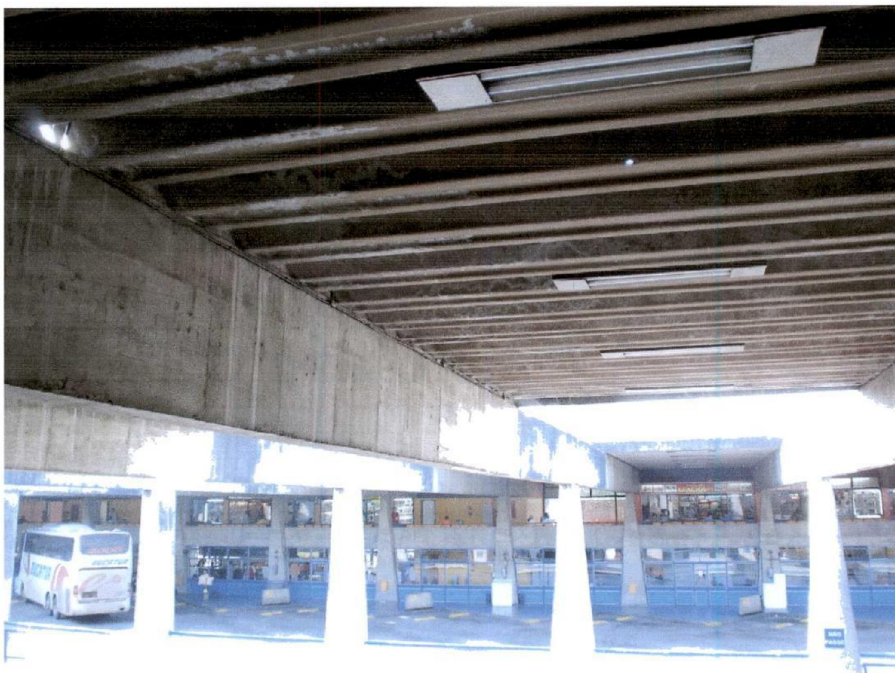
FIGURA 12 – SITUAÇÃO ATUAL DO TELHADO DA RODOVIÁRIA
