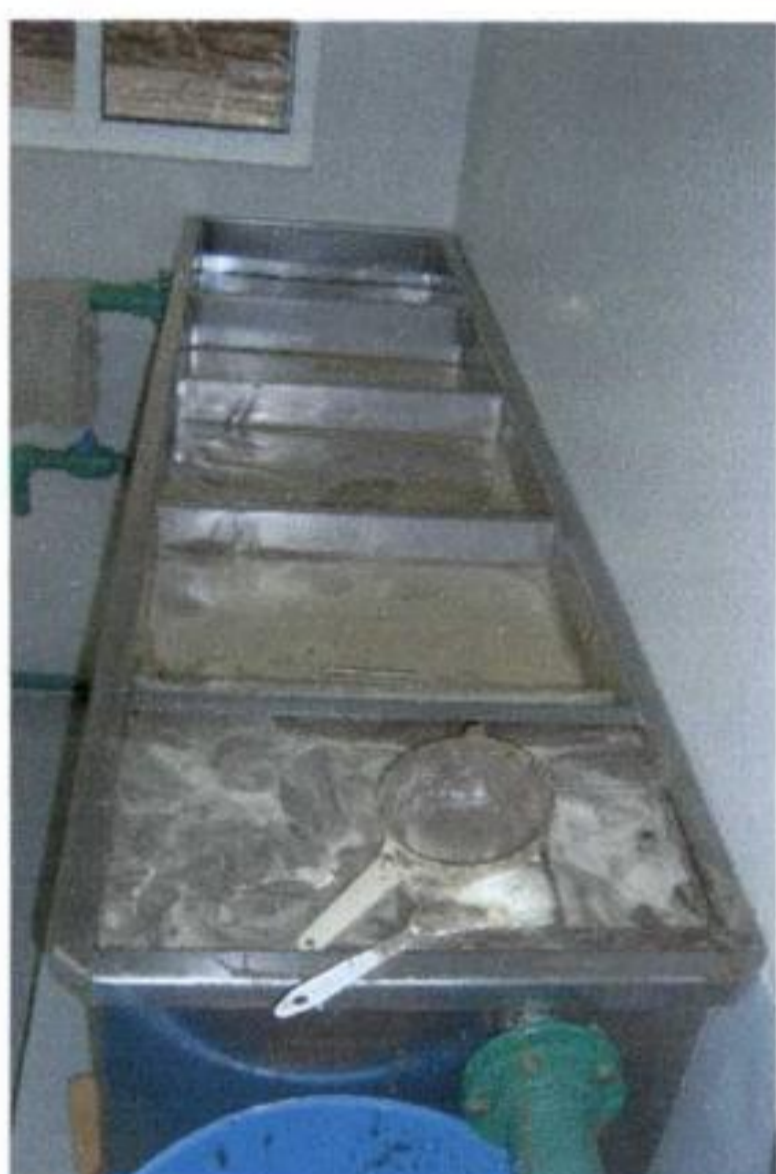
Decantador em funcionamento.
