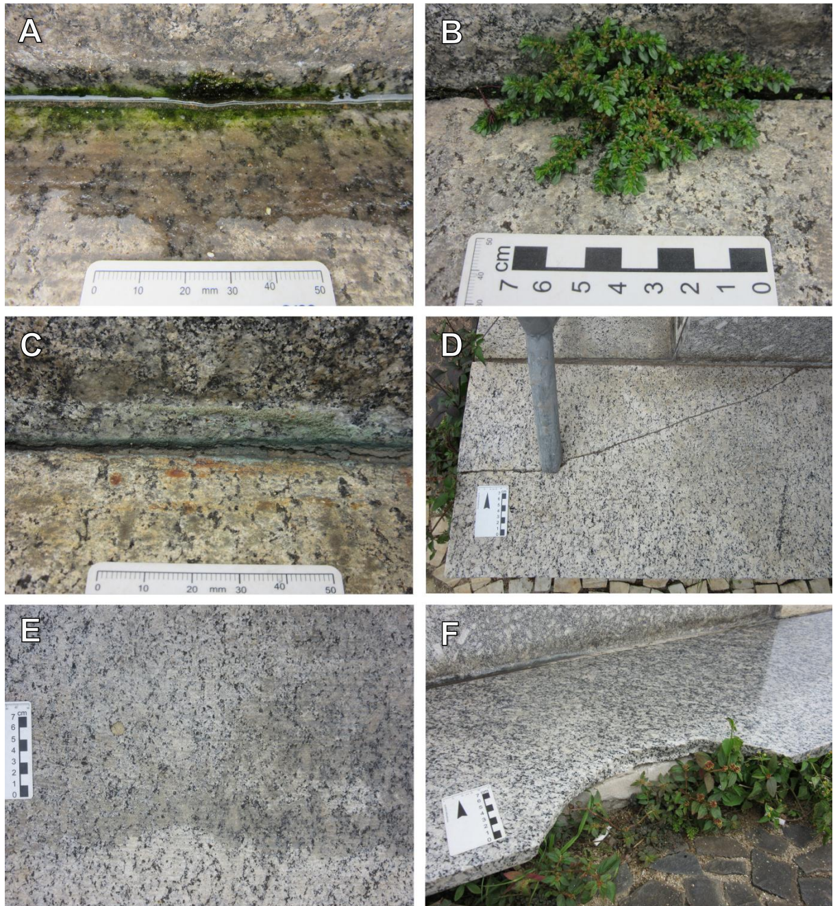
FIGURA 19 – a) Algas; b) Plantas; c) Manchas de azinhavre (óxido de cobre) e óxido de ferro; d) Fratura; e) Mancha de umidade; f) Lacuna e plantas.
