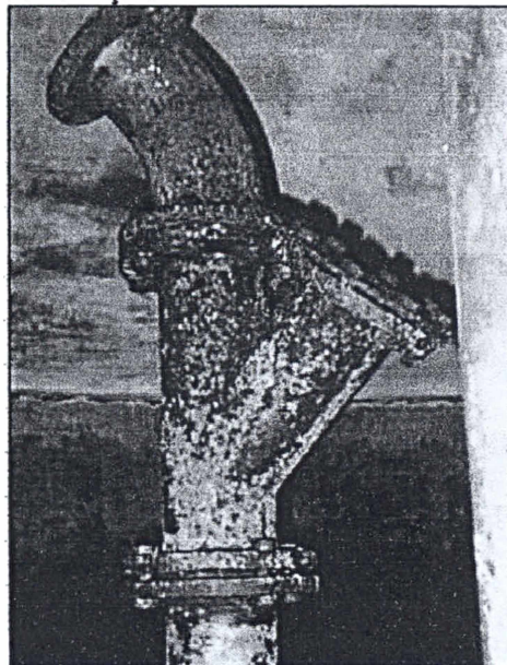
FIGURA 22 - CORROSÃO NA TUBULAÇÃO INTERNA
