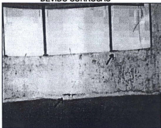
FIGURA 15 - PATOLOGIA INTERNA - EXPANSÃO DO CONCRETO DEVIDO CORROSÃO
