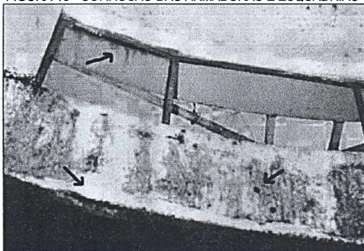
FIGURA 18 - CORROSÃO DAS ARMADURAS E ESQUADRIAS
