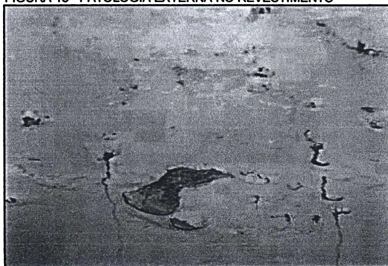
FIGURA 13 - PATOLOGIA EXTERNA NO REVESTIMENTO
