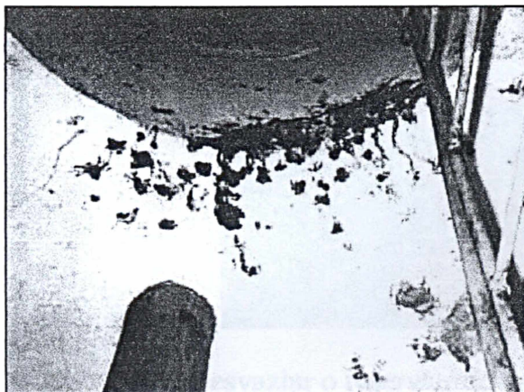
FIGURA 11 – PATOLOGIA EXTERNA – FUNGOS
