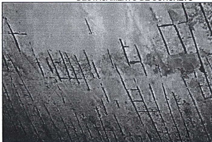
FIGURA 24 - CORROSÃO DA ARMADURA E DESTACAMENTO DE CONCRETO
