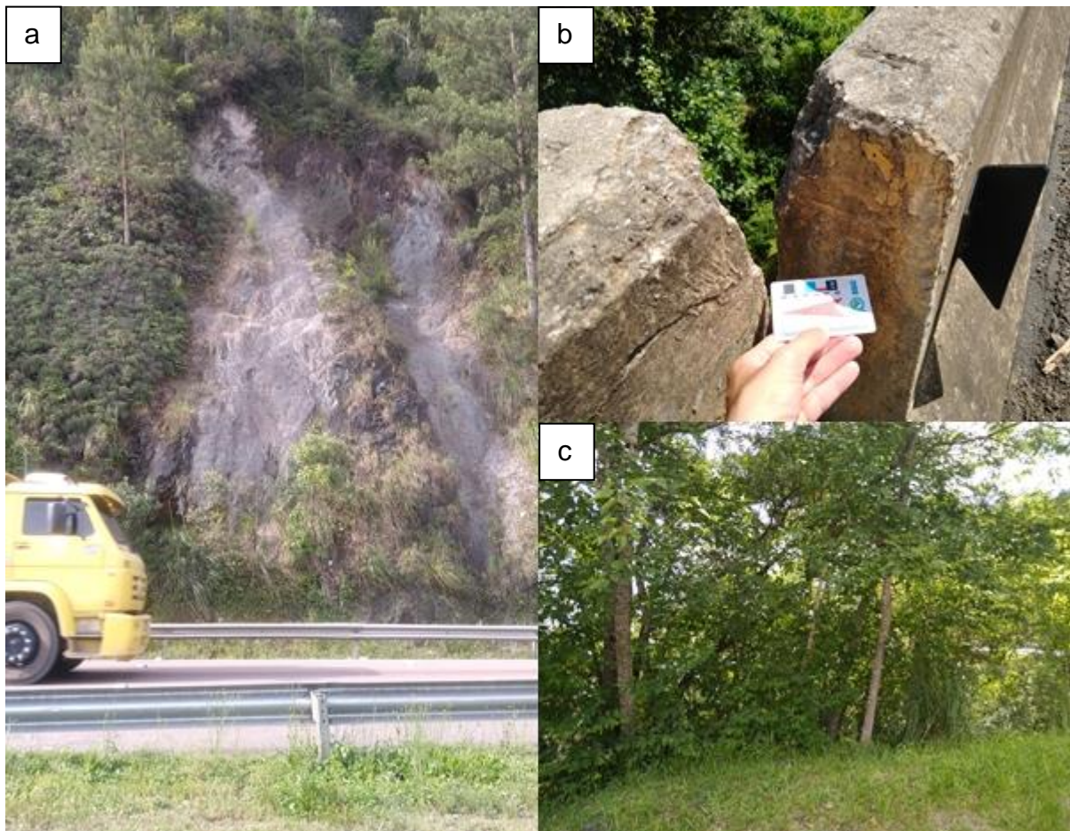
Figura 12 – a) Deslizamento translacional raso; b) deslocamento centimétrico em estrutura da rodovia; c) Árvores com troncos inclinados.
