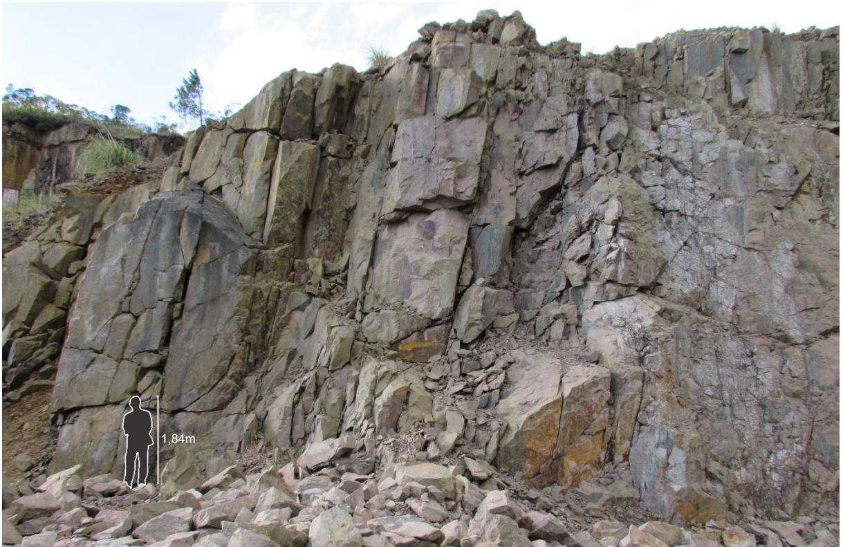
Figura 4.9: Zona 05, onde as fraturas apresentam aberturas de até 6 cm.
