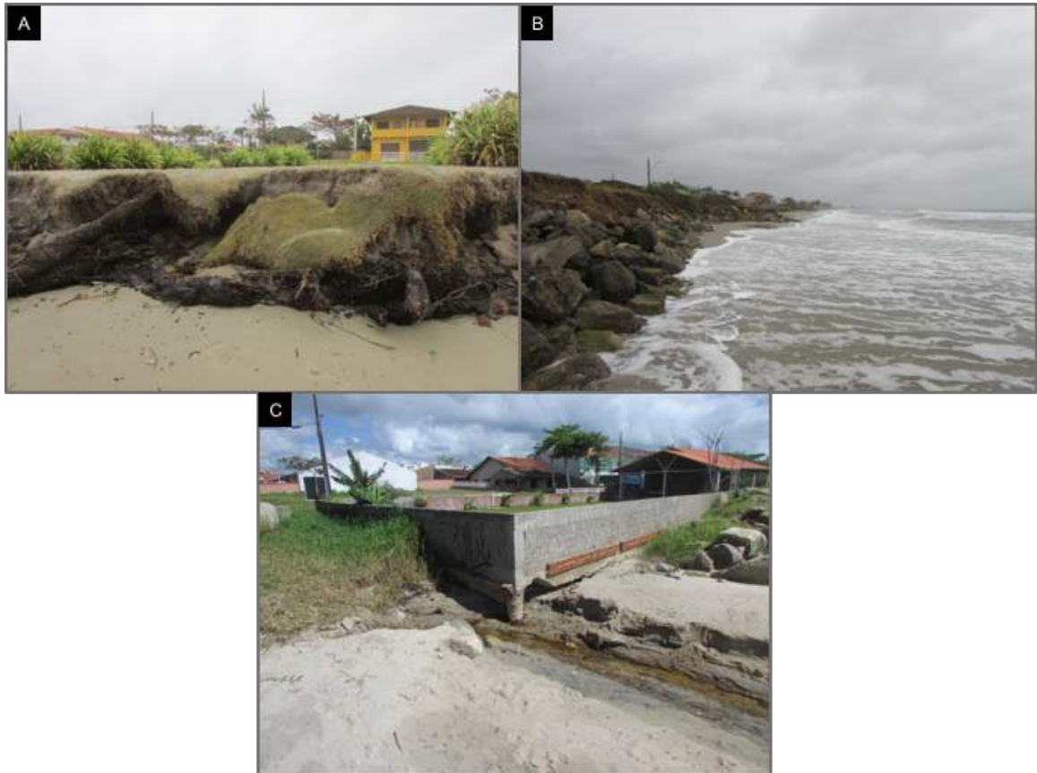
Figura 23: A) Localidade próxima ao Perfil-06, evidenciando os problemas decorrentes da erosão costeira. B) Praia próxima ao Perfil-06, evidenciando a quase ausência de perfil de praia. C) Base estrutural de construção afetada pelo processo erosivo, entre os perfis 02 e 03.
