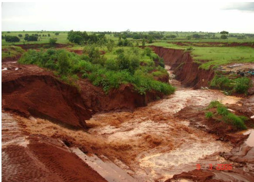
Figura 21: Notar a velocidade da água proveniente do bueiro. As escadas que deveriam reduzir a velocidade da água são insuficientes, pois há subdimensionamento na extensão e grande angulação da escada (município de Terra Rica). Fonte: MINEROPAR, 2006.
