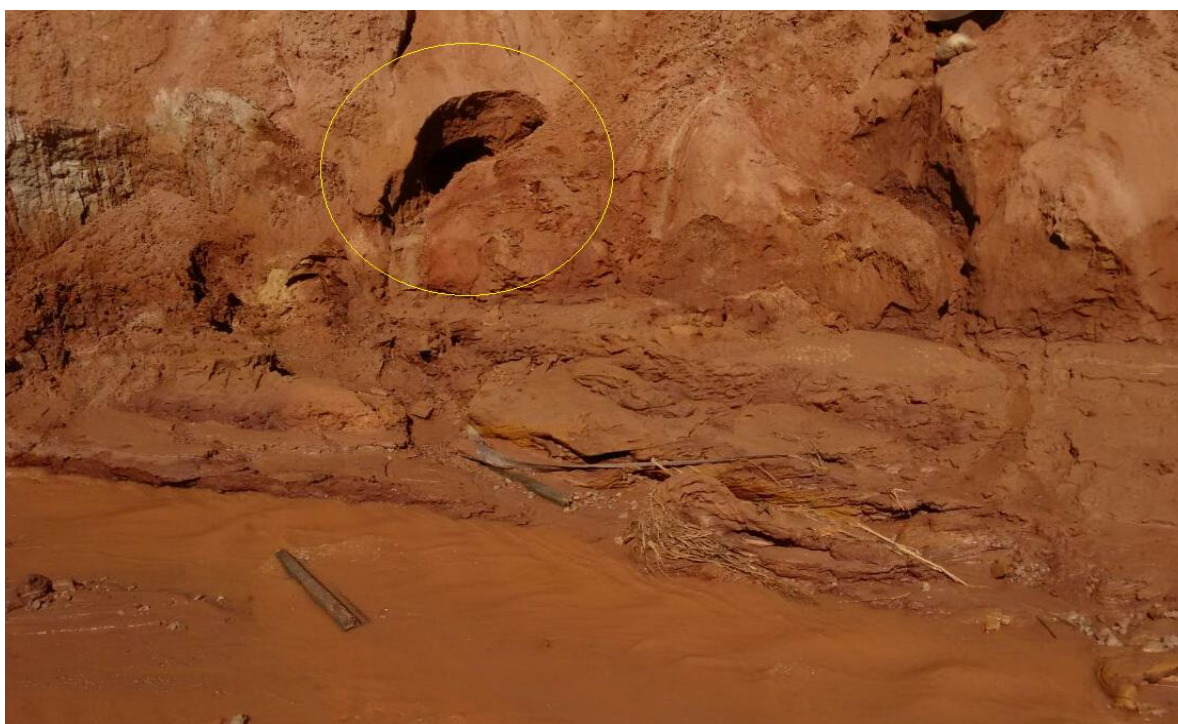
Figura 5: Formação de piping (círculo amarelo), condutos gerados pelo movimento da água em subsuperfície, essa erosão progride mesmo após o fim da chuva, por que é “alimentada” pela água do freático (Fonte: O autor, 2016).
