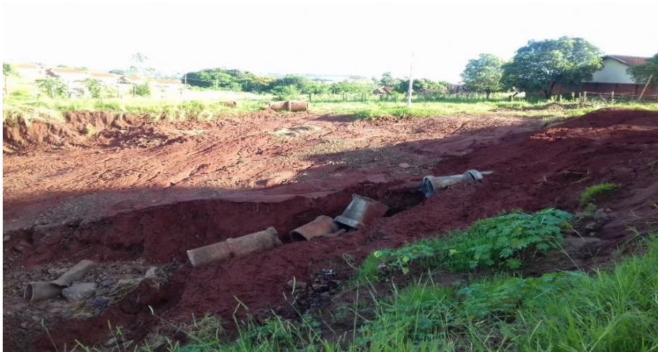
Figura 19: Desembocadura de emissário destruída pela erosão remontante no município de São Tomé -PR. Fonte: O Autor, 2015.
