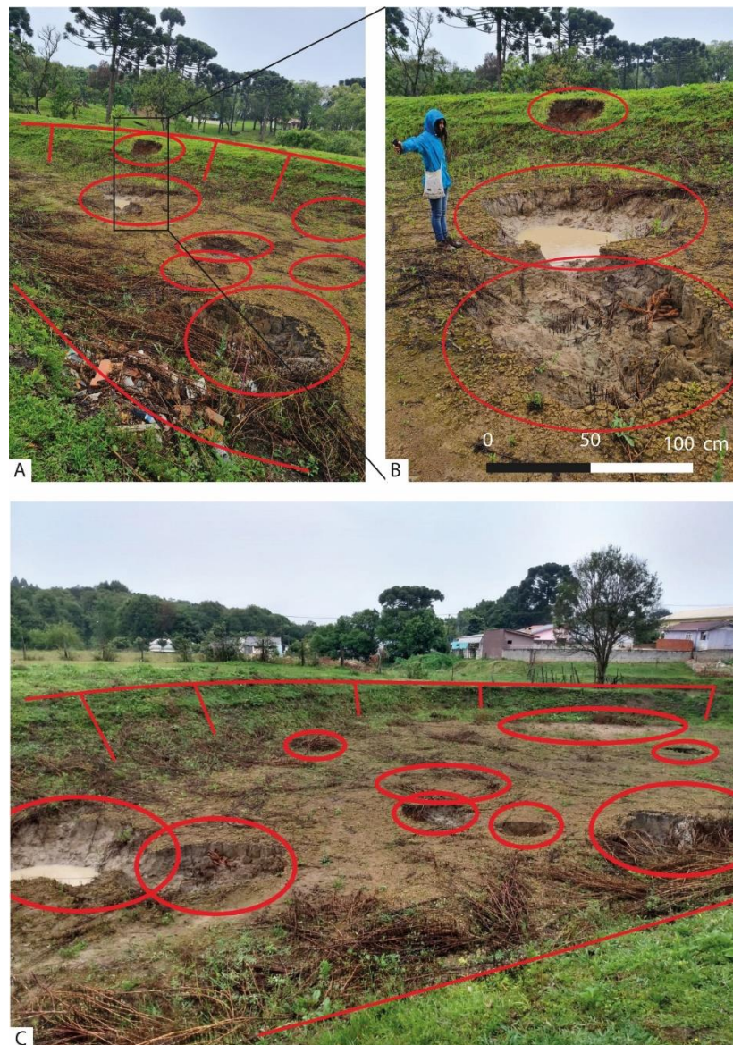
Figura 19: Dolinas de Colapso e processos de sufusão no solo, destacados em vermelho. (A) Campo de dolina Norte, (B) Destaque para dolinas alinhadas, indicativo de controle estrutural. (C) Campo de dolinas Sul. Consideradas assimétricas estruturais e simétricas, e ainda como um sistema complexo. Fonte: Fotos Lima, R.E. novembro 2022.
