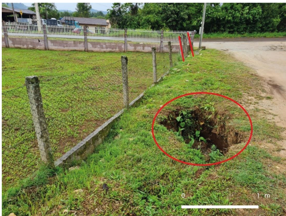
Figura 22: Dolina Colapso de solo próximo a via de acesso, e outras feições indicadoras como inclinação de postes e cercas.
