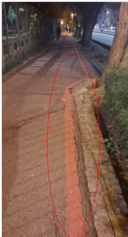
FIGURA 46 – CALÇADA DEGRADADA RUA PRESIDENTE CARLOS CALVALCANTI
