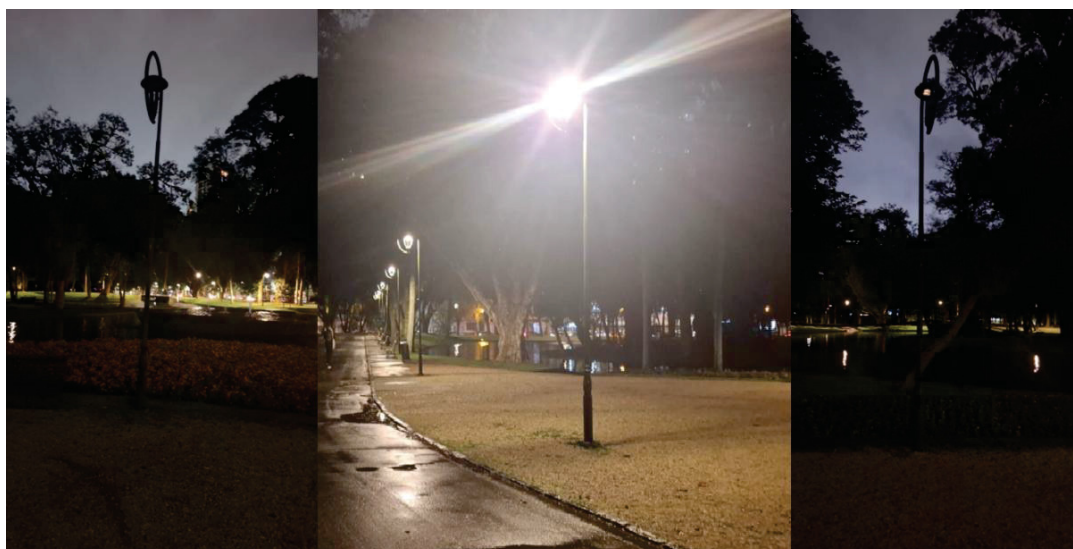
FIGURA 57 – ILUMINAÇÃO INTERNA POSTES OPERANTES E INOPERANTES
