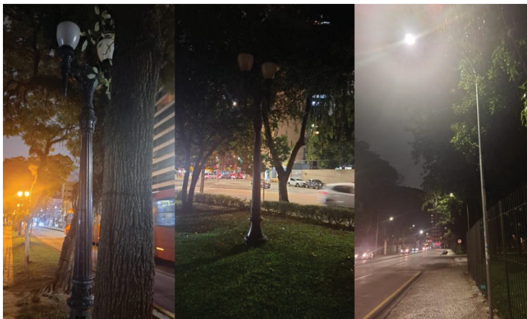
FIGURA 54 – ILUMINAÇÃO EXTERNA POSTES OPERANTES E INOPERANTES
