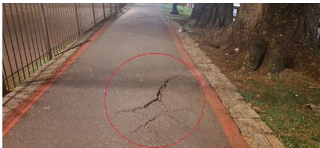
FIGURA 42 – CICLOVIA DEGRADADA RUA PRESIDENTE FARIA
