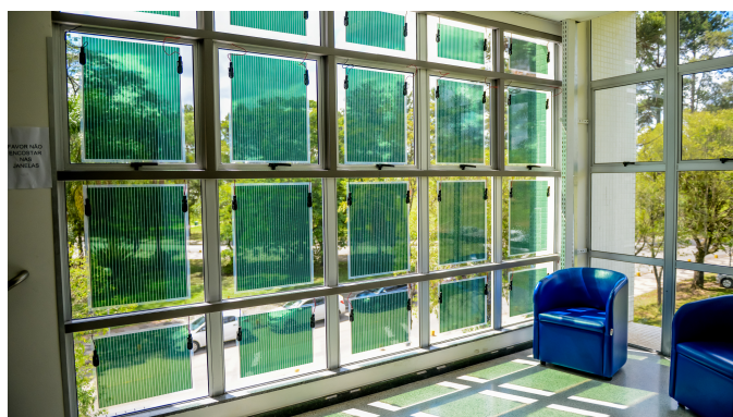
FIGURA 24 – Instalação de placas solares orgânicas no prédio PA, no Centro Politécnico da UFPR. Fonte: arquivo DiNE.
