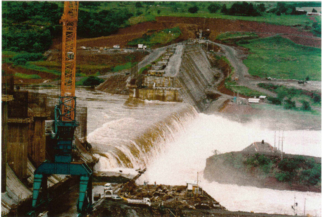
Figura 5.53 – Galgamento de parte da barragem durante a construção
