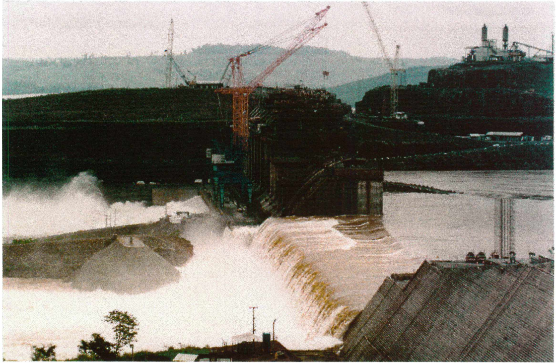
Figura 5.52 – Galgamento de parte da barragem durante a construção
