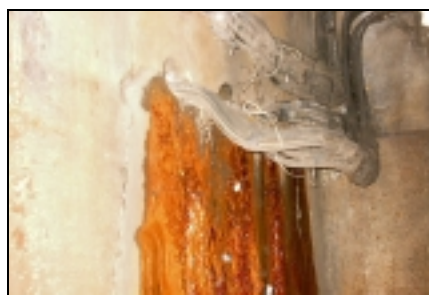
Infiltração em parede
