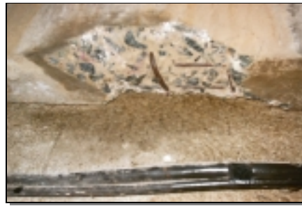
Carbonatação da viga
