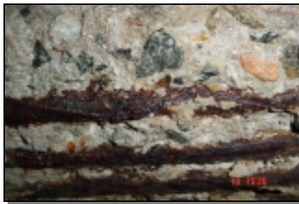
Corrosão de armadura em viga
