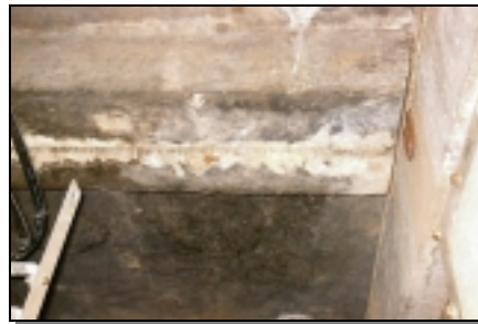
Manchas e eflorescência nas vigas
