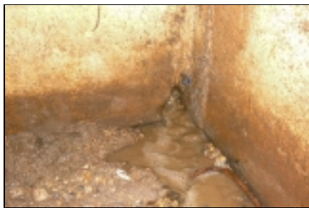
Desagregação do concreto com infiltração
