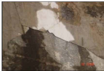
Fissuras e destacamento em paredes
