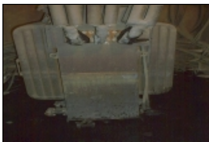
transformador de energia elétrica
