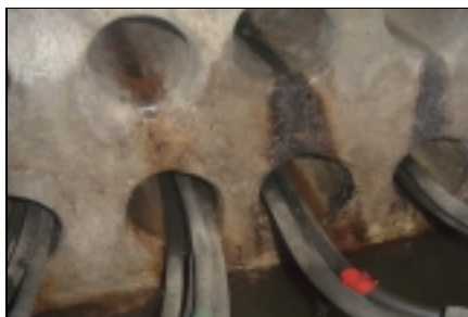
Bocais para passagem de cabos
