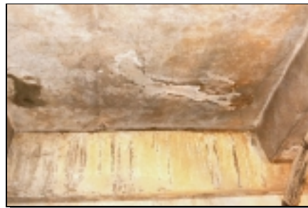
Umidade e manchas na tampa da câmara
