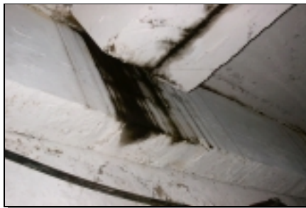
Presença de limo nas vigas
