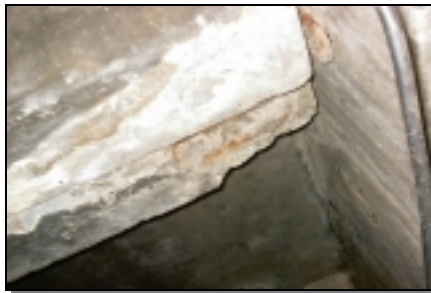
Carbonatação em vigas
