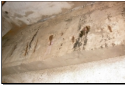
Exposição de armadura em vigas
