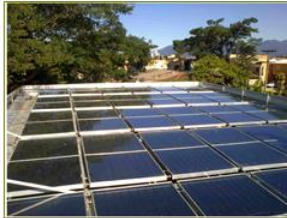
FIGURA 7 – PAINÉIS SOLARES - ETE BROOKS
