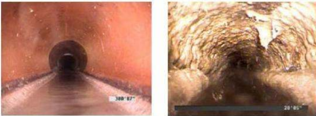
Figura 04- Tubulação antes e depois do óleo de cozinha
