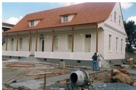
FIGURA 62 – OBRAS DO CASARÃO. IRMÃ OLIVA SUPERVISIONA AS OBRAS DE RESTAURAÇÃO DO CASARÃO FONTE: www.colegiosantacandida.com.br
