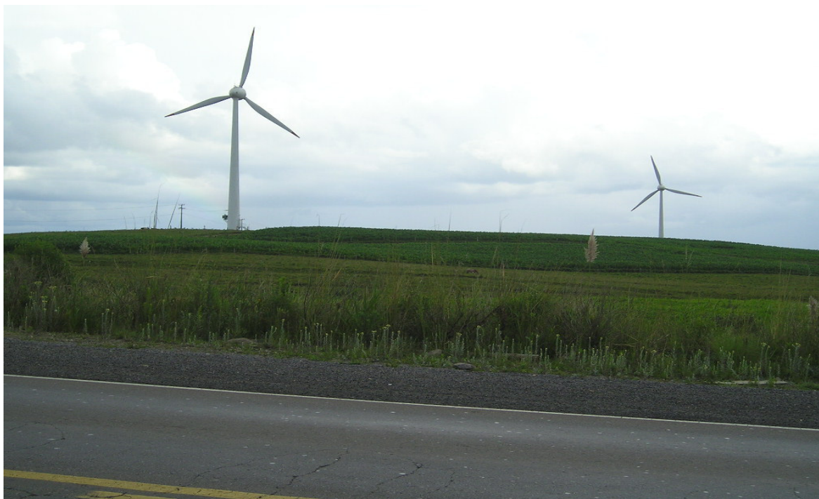
Fig. 04 – Usina eólica de Palmas – PR Foto da autora.
