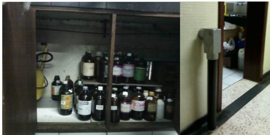
FIGURA 27 – ARMÁRIO COM VENTILAÇÃO NATURAL E REDE ELÉTRICA ESTRUTURADA FONTE: A autora
