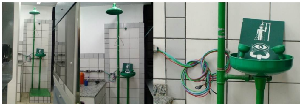
(a) Instalações não conformes
