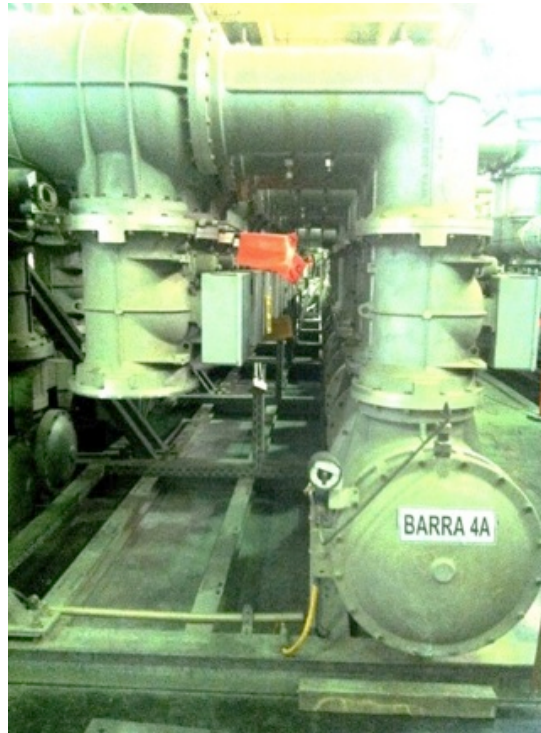
Figura 35. Deslocamento dos compartimentos da barra ao qual o seccionador estava instalado.
