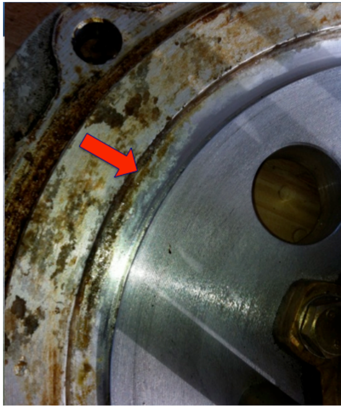
Figura 38. Ilustração corrosão na sede de o-ring em flanges metálicas de equipamentos a SF 6 . Fonte: O autor, 2012
