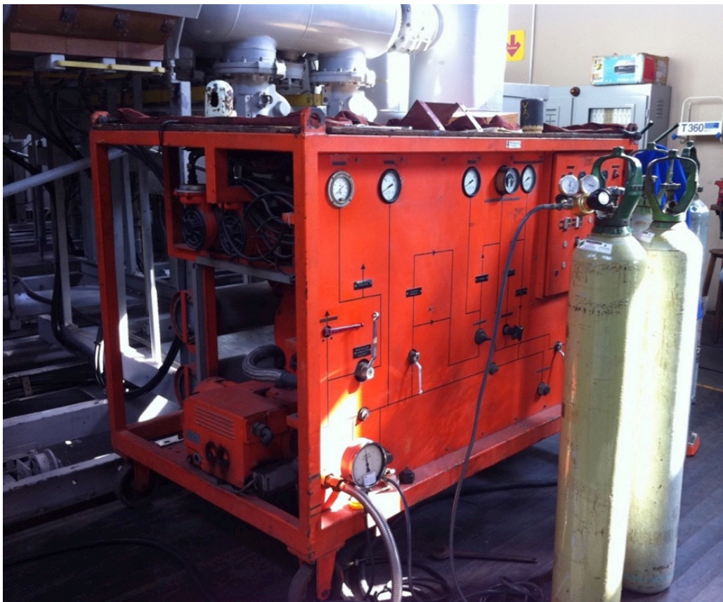
Figura 7. Equipamento de manobra e filtragem de gás SF 6 . Fonte: O autor, 2012.
