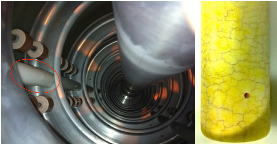
Figura 5. Visão interna de equipamento elétrico isolado a SF 6 e detalhe de taque químico (com revelador) a espaçador/isolante polimérico. Fonte: O autor, 2013.
