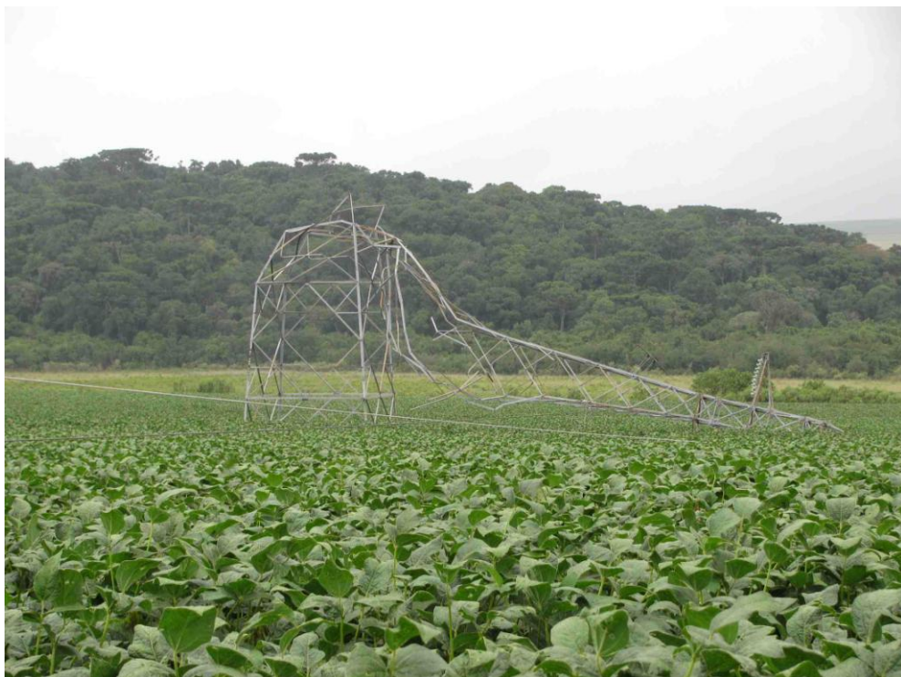
FIGURA 3.6 – QUEDA DA ESTRUTURA 93 DA LT IRATI – SABARÁ FONTE: WAZEN 2011
