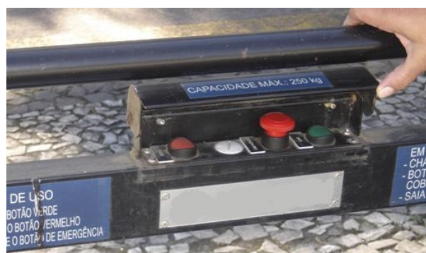
Figura 3.2: Detalhe da caixa de comando. Fonte: autora, (ER)
