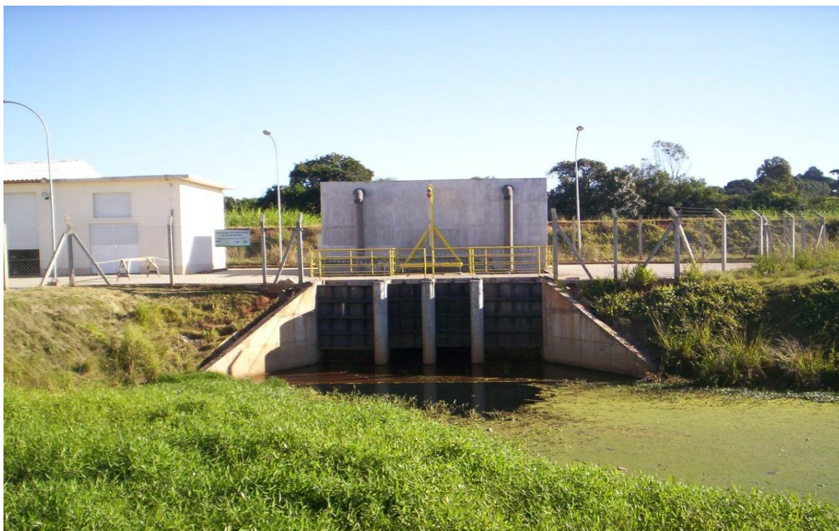
FIGURA 28 - ESTAÇÃO DE BOMBEAMENTO DA SANEPAR, VILA ZUMBI DOS PALMARES
