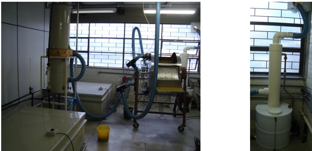
FIGURA 11 – FOTOGRAFIAS DO SISTEMA DE UMIDIFICAÇÃO DO AR E DA LAVADORA DE GASES
