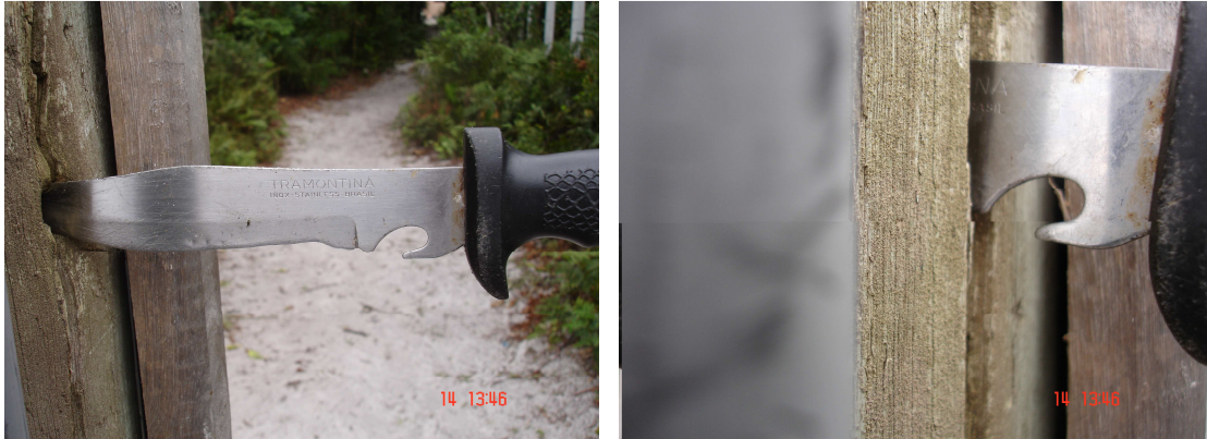
FIGURA 3 - TESTE PARA VERIFICAÇÃO DA PROFUNDIDADE DO FENDILHAMENTO. FONTE: A autora (2007)
