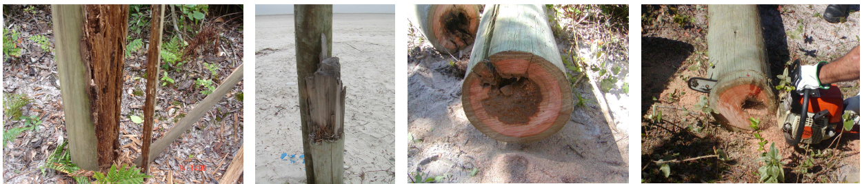
a) b) c) d) FIGURA 11 - POSTES PARA ANÁLISES ANATÔMICAS: a) N° 86, b) 101, c) 119 e d) 120 FONTE: A autora (2007)
