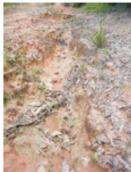
Figura 2-estágio avançado de erosão (ravinação) em trilha de acesso à barragem Autoria: Leandro Guimarães
