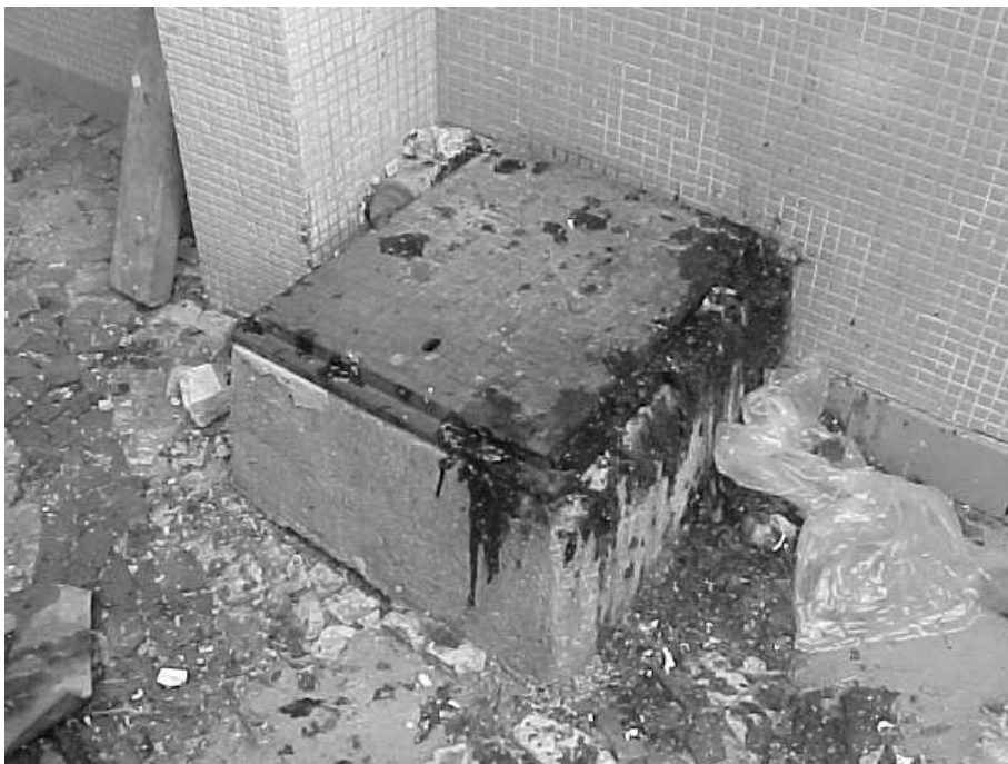
FIGURA 13 – CAIXA DE GORDURA INADEQUADA FONTE: O AUTOR, 2005
