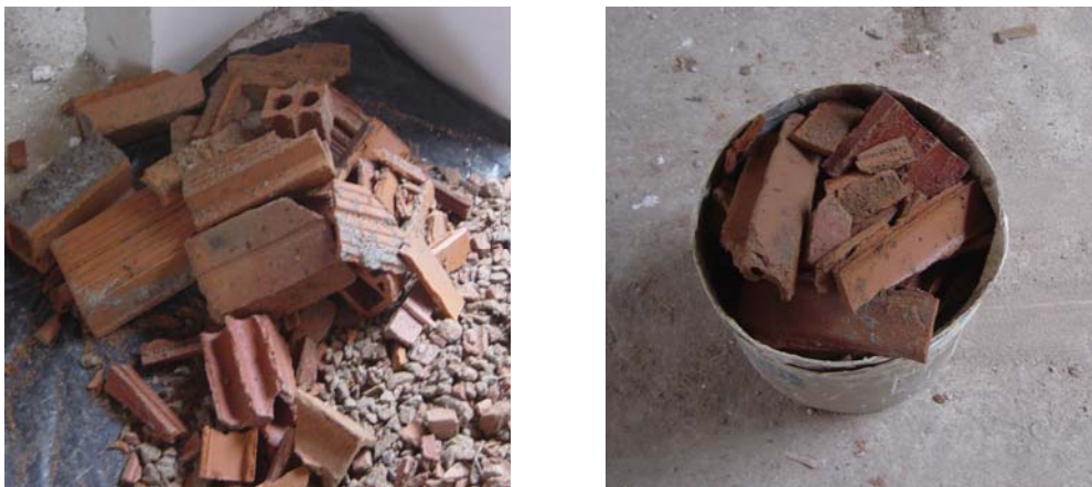
FIGURA 4.4 – RESÍDUOS DISPOSTOS NA BAIA CLASSE A3
