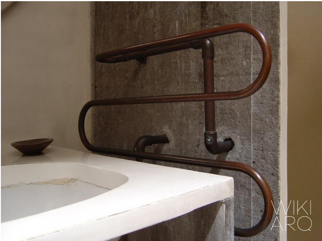
Figura 41: Instalação hidráulica aparente. Fonte: wikiarq.com.
