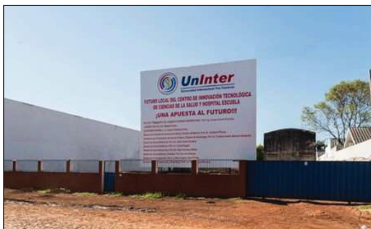
Figura 30 - Futuro local do centro de inovação tecnológica de ciências da saúde e hospital escola – UNINTER
