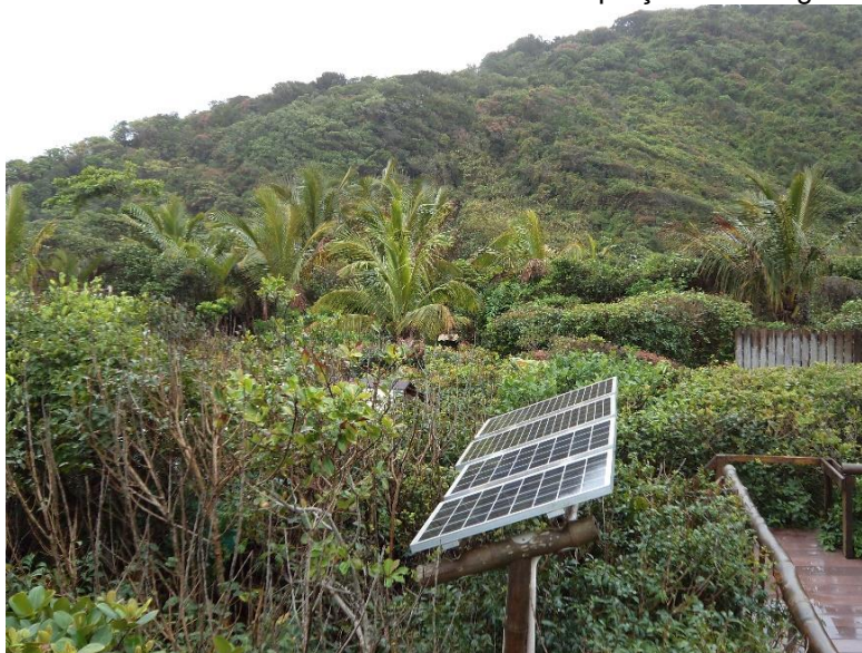
FIGURA 12: Painéis Fotovoltaicos usados na captação de energia solar.
