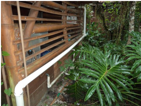
FIGURA 14: Sistema de calhas.
