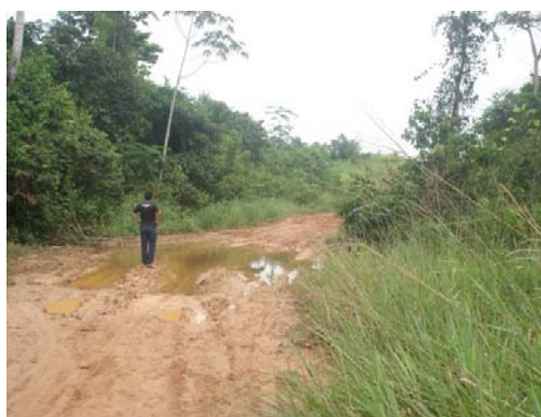
FIGURA 8: AS PÉSSIMAS CONDIÇÕES DOS RAMAIS NO MUNICÍPIO DE BRASÍLIA.
