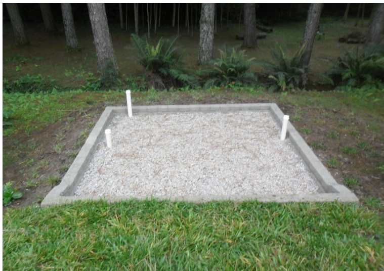
Figura 06. Estação pronta para receber o efluente
