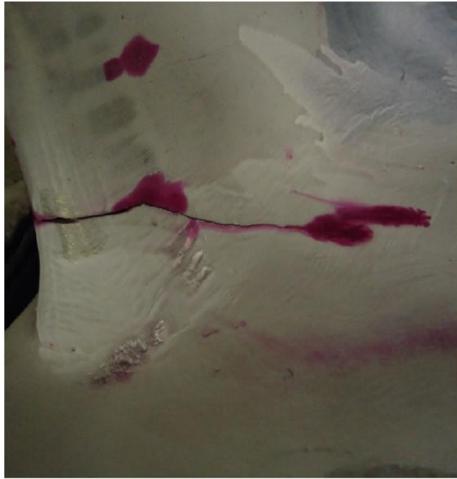
Figura 2.1 - Aspecto de uma trinca na pá do rotor da unidade 03 de UHEGBM. (retirado de Relatório técnico referente à recuperação de trincas no rotor da turbina da unidade 03 de UHEGBM, 2001).
